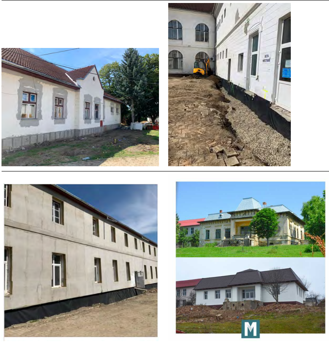
Figura 51: Exemple cu probelem la fundație, izolație, tâmplărie, acoperiș
