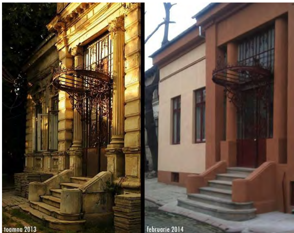
Figura 52: GRESIT: Izolația termică exterioară, distrugerea elementelor arhitecturale ale fațadei, anularea completă a identității istorice a clădirii, zugrăvirea în culori neadecvate, imobil București
